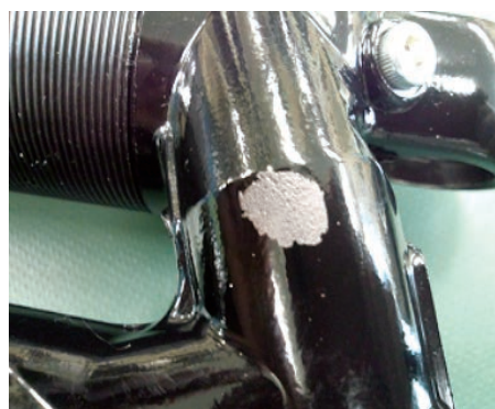
写真1 剥離（アルミ材）
