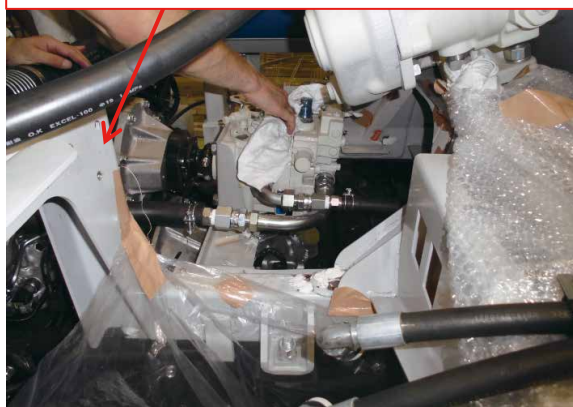
写真10 ポンプ脱着確認会の様子
