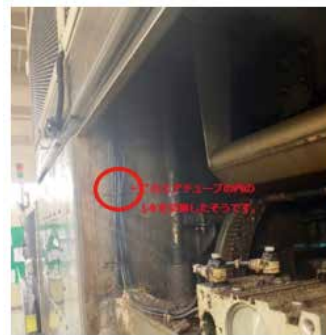
写真2 異常2のチューブ劣化箇所
