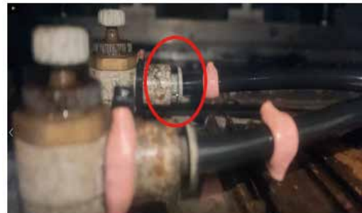
写真1 異常1のエア漏れ箇所
