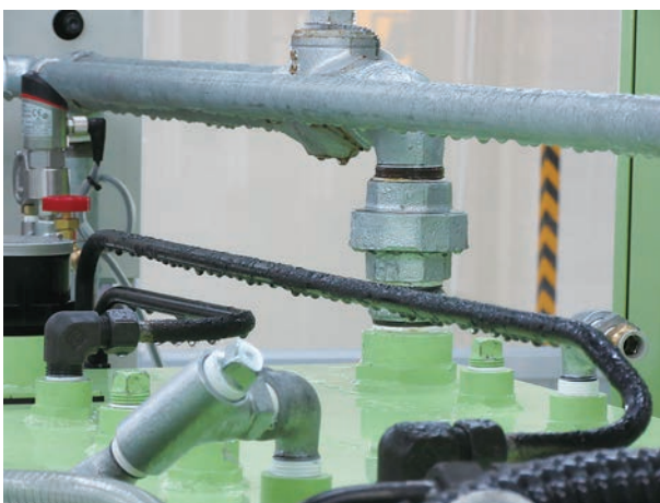
写真12 油圧配管の結露
