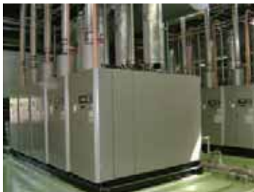
小型貫流ボイラ(岐阜南工場)
