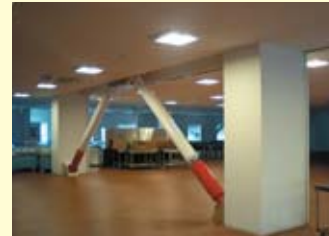
制震用オイルダンパの設置例 (岐阜北工場)
