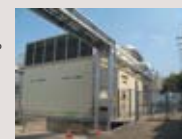
ESCO事業によるコージェネレーションシステムの導入
