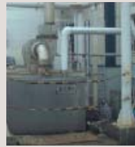
アルカリ廃液減容機 (相模工場)
