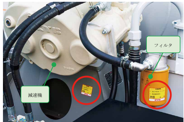
写真3 オイルメンテナンスシール貼り付け位置
